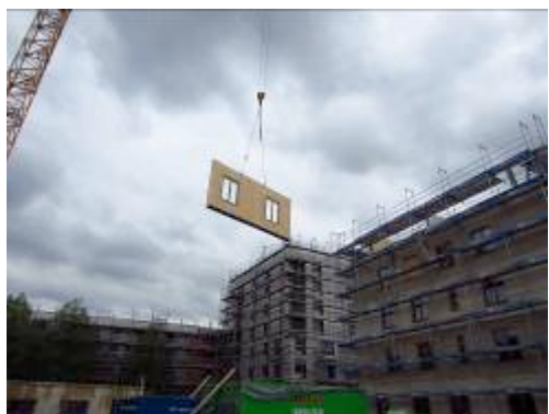
Das Schließen der Fassadenfläche und der Aufbau der Staffelgeschosse erforderte nur 18 Tage. (Foto: agmm Architekten + Stadtplaner)
